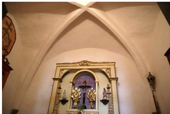
Figura 6: Casa Rocha, abóbada nervurada no piso térreo, actual oratório (foto: Mafalda Pacheco)
